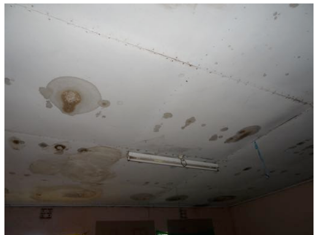
Decke mit Wasserflecken
